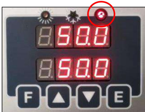
Led Acceso -contatto chiuso
